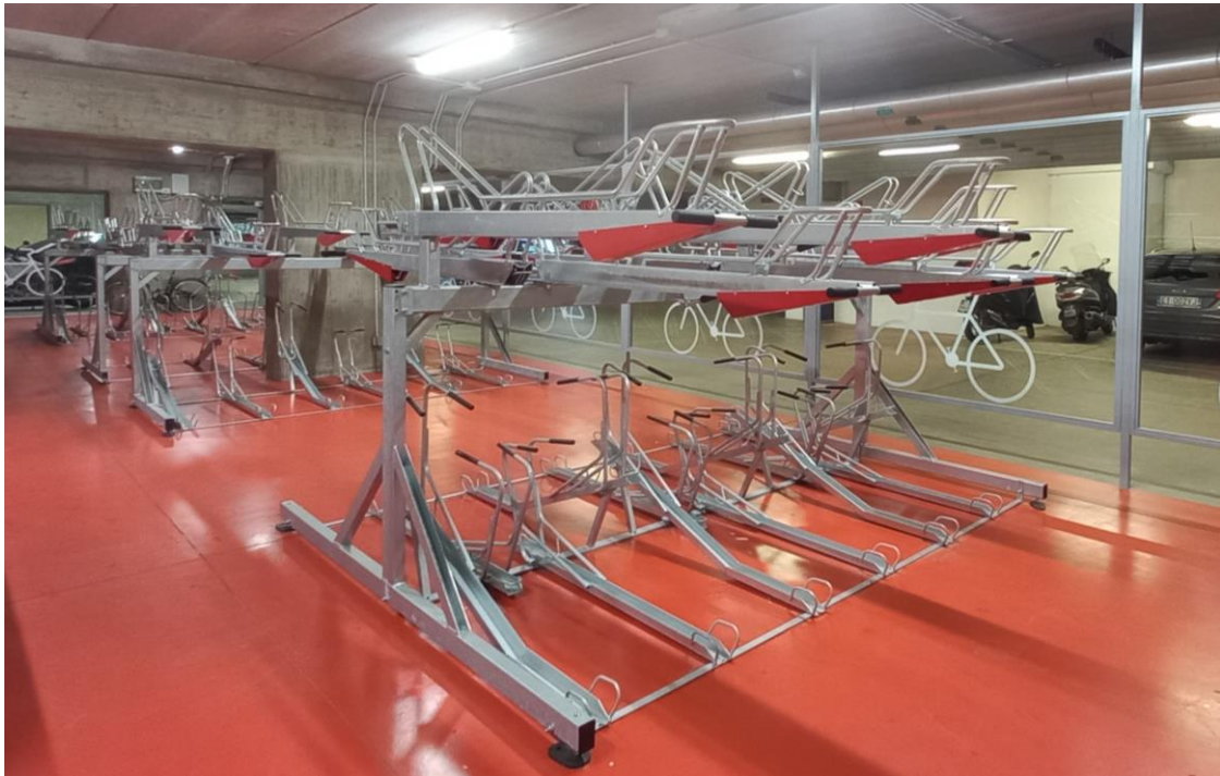
Figura 111: Sistemi Park Up
