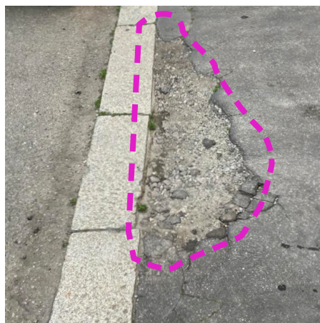
Via G. Pacini, alterazione pavimentazione
