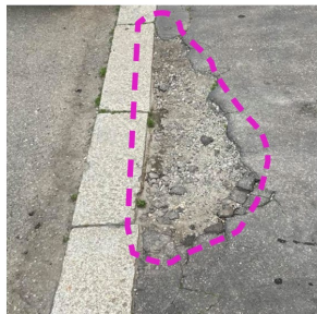
Via G. Pacini, alterazione pavimentazione
