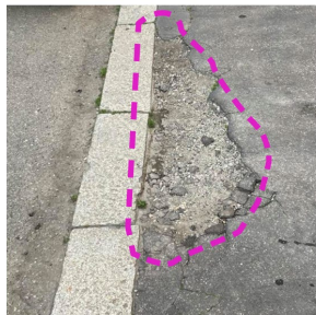
Via G. Pacini, alterazione pavimentazione
